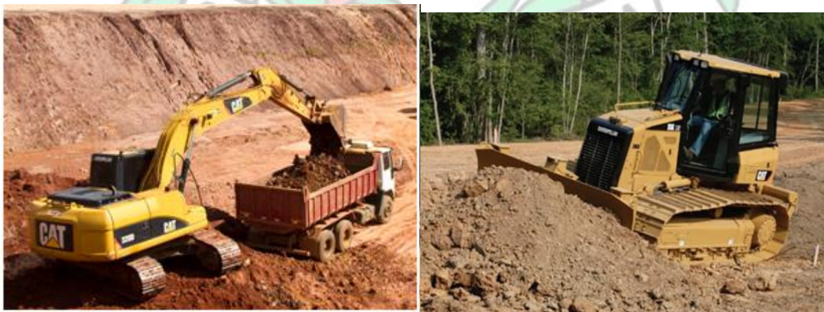
Foto 03: Equipamentos principais para o sistema de compactação e cobertura.
